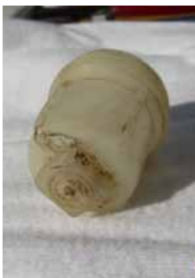
割れたストレーナキャップ
